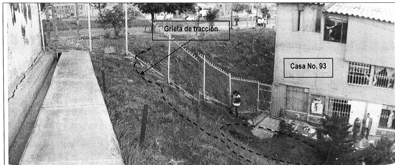
Fotografía No. 3. Se observa el proceso de remoción en masa de carácter local y la grieta de tracción que se extiende hacia el costado norte del conjunto residencial parques del Tunal 4, delimitando una cuña potencialmente inestable de unos 25 m 3 de material.
