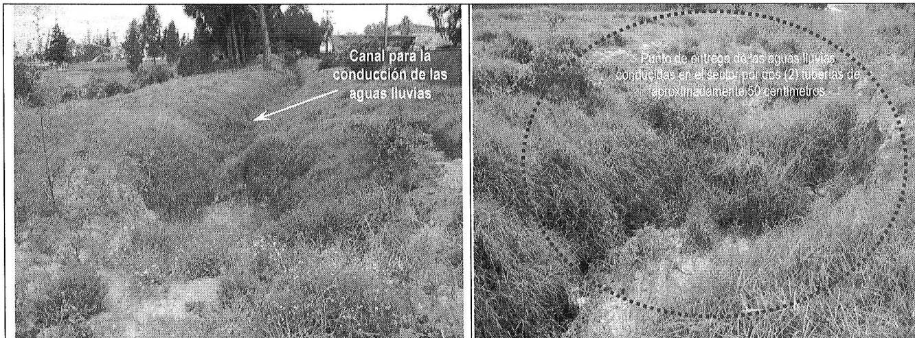
Foto 4 y 5. Aproximadamente a 70 metros del sector donde se identificó el asentamiento brusco del terreno y hacia el costado Norte oriental, se ubica el punto de entrega de las dos (2) tuberías de aproximadamente 50 centímetros, que según la información aportada por personal del contratista de la Empresa de Acueducto y Alcantarillado de Bogotá - EAAB, conducen aguas desde predios a cargo de la Ladrillera Santafé S.A. Según lo observado el punto de entrega se encuentra posiblemente obstruido por vegetación y suelo.
