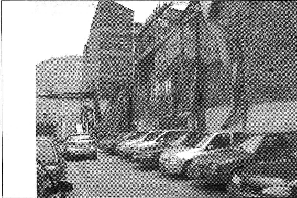
Fotografía 4 y 5. Zona de riesgo en el parqueadero de la Carrera 4 # 19 - 64.
