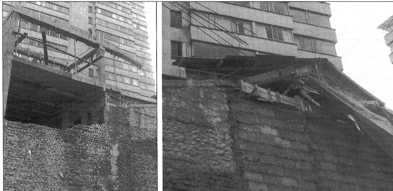
Fotografía 4 y 5. Deficiencias en los procesos constructivos, como ausencia de apuntalamiento de los primeros niveles para fundir niveles superiores, etapas constructivas desordenadas que darían lugar a juntas frías innecesarias y hormigueros en los elementos estructurales ya fundidos. Carrera 4 # 19 – 56.
