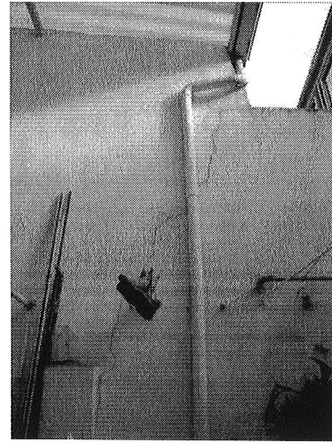
Foto 7. Evidencia de la presencia de grietas de tendencia diagonal en muros de cerramiento perimetral, al interior de la estructura ubicada al costado nor-oriental del predio evaluado.
