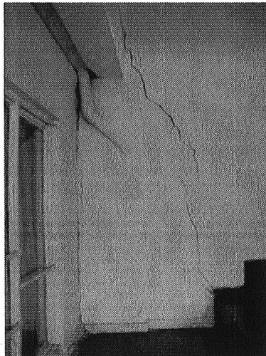
Foto 6. Evidencia de la presencia de grietas de tendencia diagonal en muros de cerramiento perimetral en el sector de las escaleras, al interior de la estructura ubicada al costado nor-oriental del predio evaluado.
