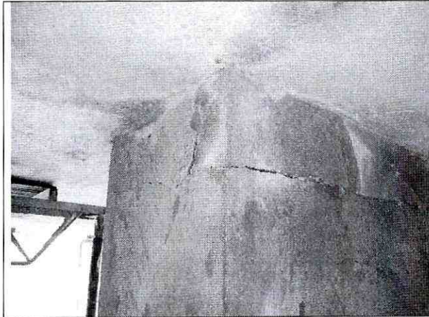
Foto 4. Grieta de tendencia horizontal en la parte alta de un muro divisorio, la cual exhibe además desplazamiento horizontal.
