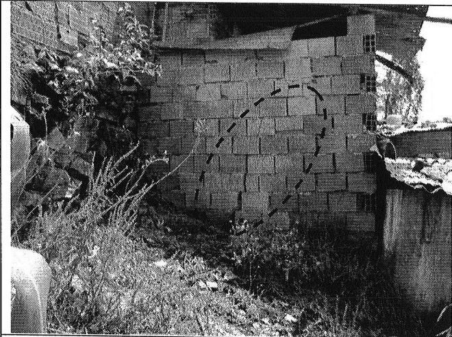
Fotografía No. 5. Vista desde el costado norte del predio de la Carrera 5 Este No. 162C-41 Interior 1, se observa el agrietamiento severo de patrón diagonal sobre el muro de cerramiento del costado Norte.
