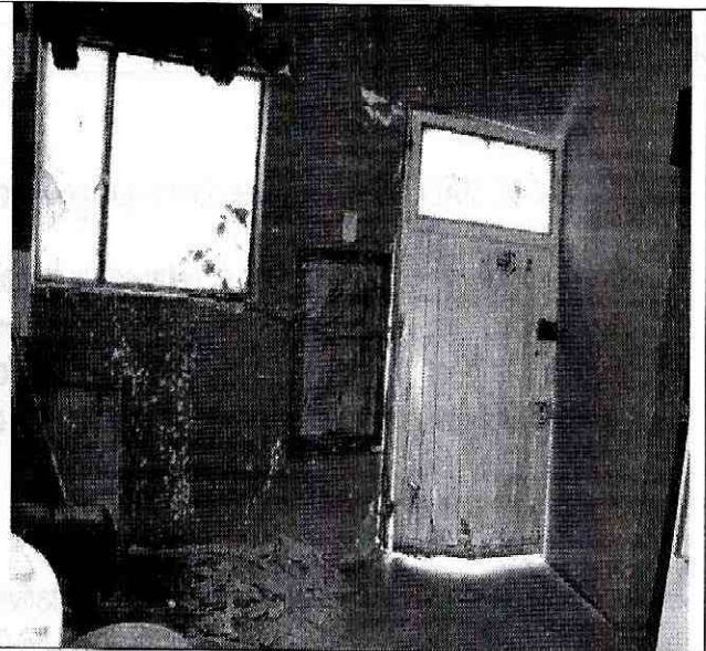
Foto 2. Sector de la fachada de la vivienda, afectado en sus muros y carpintería metálica por el impacto.
