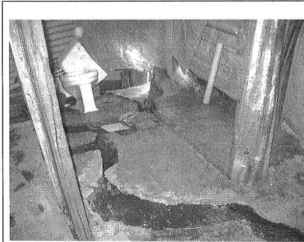
Foto 3. Falla losa de contrapiso en concreto simple; afectación severa de servicios sanitarios, vivienda Calle 163A Bis A No. 2-04 Este
