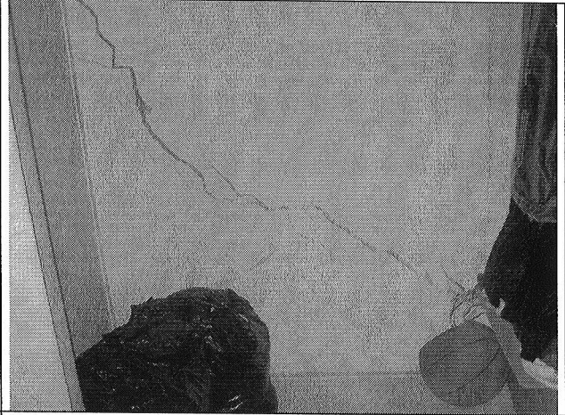
Foto 2. Grieta de tendencia diagonal en muros divisorios del costado norte de la torre oriental del predio de la Transversal 18A No. 97-29.
