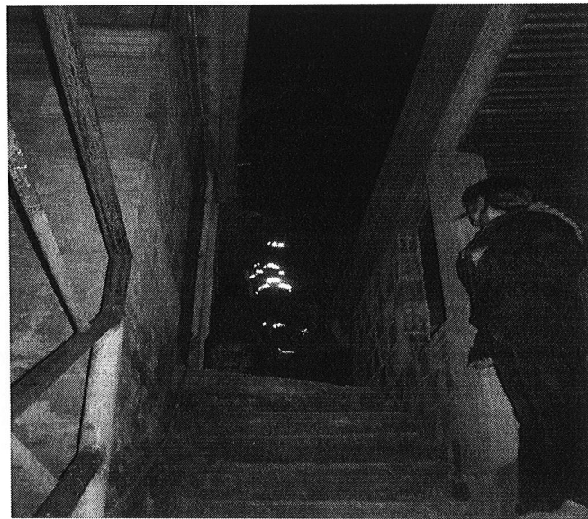
Fotografía 4. Aspecto del interior de la vivienda localizada en la Carrera 2C No. 163-28 Barrio Santa Cecilia Parte Alta, sector donde se localizan las habitaciones arrendadas, alcalzadas en la parte exterior de la vivienda. Se evidencia la realización reciente de obras de ampliación.
