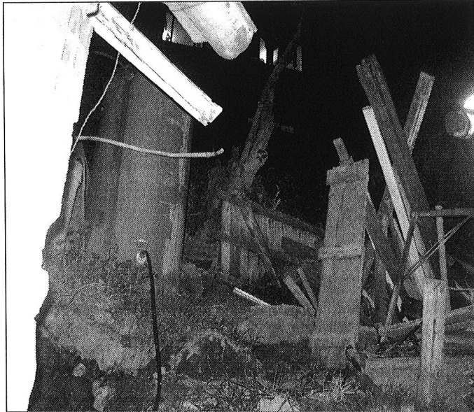
Fotografía 3. Detalle de los materiales que conformaban la estructura de contención artesanal instalada en el talud de corte, las cuales colapsaron generando el desconfinamiento del mismo. Vista desde la vivienda de la Carrera 2C No. 163-28 Barrio Santa Cecilia Parte Alta.
