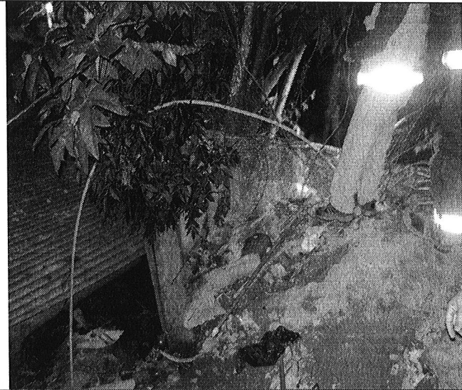
Fotografía No. 1 Desconfinamiento del talud de corte entre predios privados, visto desde la Carrera 2B No. 163A - 15. Se observa que dicho talud se encontraba contenido por tejas de zinc y elementos de madera
