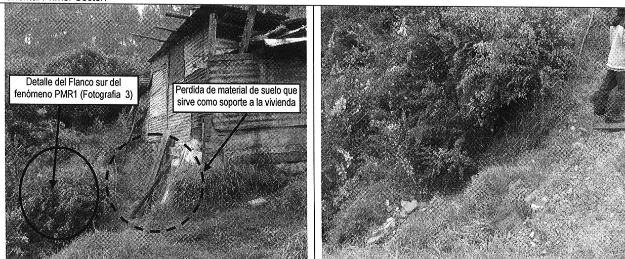
Fotografía 2. Detalle de la pérdida de suelo de soporte que sirve como apoyo a la vivienda de la Manzana 18 Lote 9.
