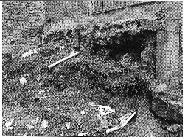
Foto 4. Exposición de elementos de la cimentación de la vivienda del costado sur del Interior 4, afectación previa a la falla de muro de confinamiento del relleno.
