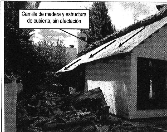
Foto 1. Desprendimiento de aproximadamente 10 m 2 de la cobertura de teja de barro e impermeabilizante que forma parte del sistema de cubierta de la edificación emplazada en el predio de la Carrera 7 D # 108 A - 15, Barrio Santa Ana Occidental de la Localidad de Usaquéen
