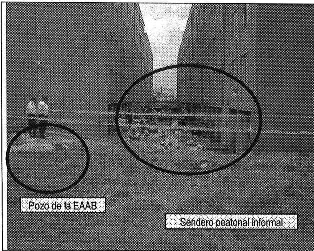
Foto 3. Vista del costado sur, donde se presenta el colapso del muro de cerramiento y se observa un sendero peatonal informal, ocupado por gramíneas nativas.
