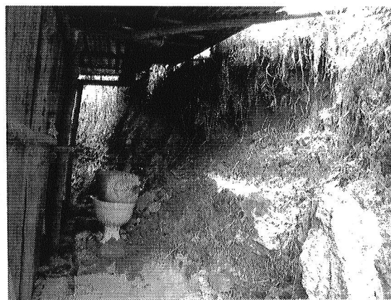
Fotografía 2. Detalle del talud de corte del costado sur del predio de la referencia, afectado por caída de materiales que compromete la funcionalidad del baño de la misma.
