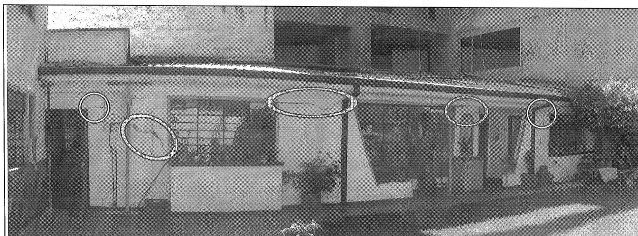
Foto 3. Vista de la unidad habitacional del costado norte del predio de la Calle 103A No. 11B-54. Apréciase el agrietamiento profuso que se presenta en muros.
