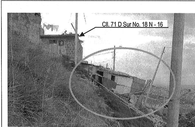
Fotografía 1. Predio vecino a la Calle 71 D Sur No. 18 N – 16, Barrio Villas del Diamante, afectado por colapso parcial de la estructura inducido por un proceso local de inestabilidad del terreno.
