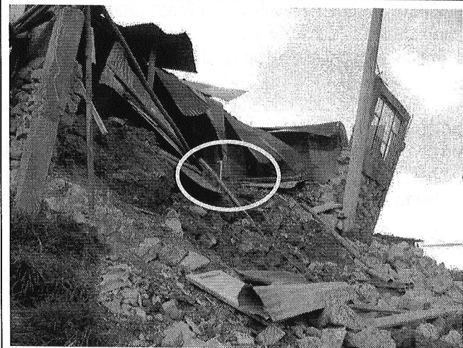
Fotografía 4. Detalle de la tubería de agua potable al interior del predio de la referencia, el cual posiblemente pudo generar la saturación del terreno por ruptura del mismo.
