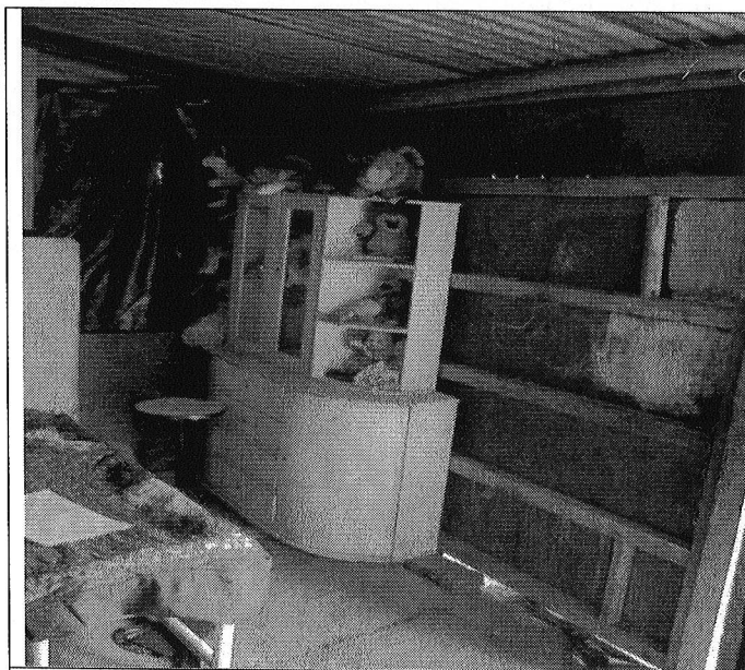
Fotografía 3. Se observa el primer nivel de la vivienda donde se aprecia la pérdida de verticalidad de los elementos divisorios y la carencia de elementos de confinamiento. Mayo 14 de 2009.
