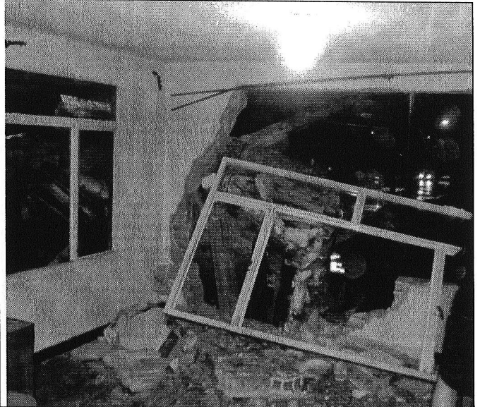
Fotografía 2. Colapso parcial del antepecho y marco de la ventana del costado sur a la altura del segundo nivel de la edificación emplazada en el predio de la Av. Carrera 104 # 77 B - 23.
