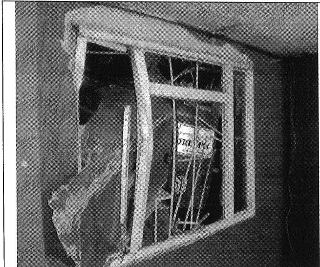
Fotografía 3. Colapso parcial del marco de la ventana del costado oriental del primer nivel de la edificación emplazada en el predio de la Av. Carrera 104 # 77 B - 23.
