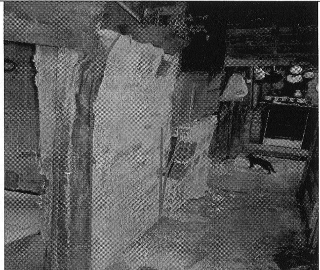
Fotografía 2. Interior de la vivienda primer nivel, se evidencia la pérdida de verticalidad de los muros divisorios los cuales no cuentan con elementos de confinamiento tipo vigas y columnas y se observa carencia de material de pega entre los elementos que lo conforman. Mayo 7 de 2009.
