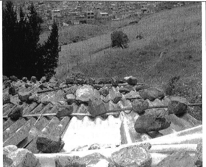
Fotografía 8. La cubierta no cuenta con adecuados elementos de anclaje y las tejas que conforman la misma están siendo sostenidas mediante rocas de tamaño significativo, las cuales sobrecargan la estructura y posiblemente ocasionen daños adicionales sobre la misma.
