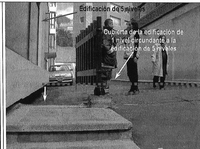
Foto 4. Se observa la pérdida de horizontalidad de la cubierta de la edificación de 1 nivel circundante a la edificación de 5 niveles.
