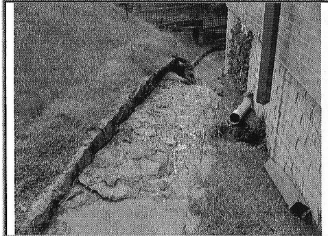
Foto 18. Canal rectangular escalonado que presenta agrietamientos
