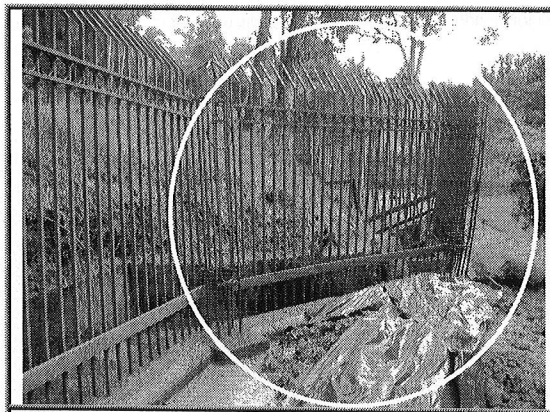
Foto 9. Desprendimiento de material proveniente del sector central de un talud de corte ubicado al costado oriental del predio ubicado en la Carrera 1B No. 54-45
