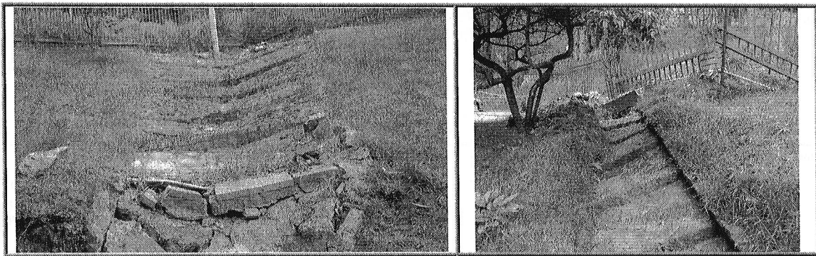
Foto 16. Evidencia de la presencia de grietas y deformaciones en el canal de sección triangular ubicado al costado sur-oriental del predio evaluado.
