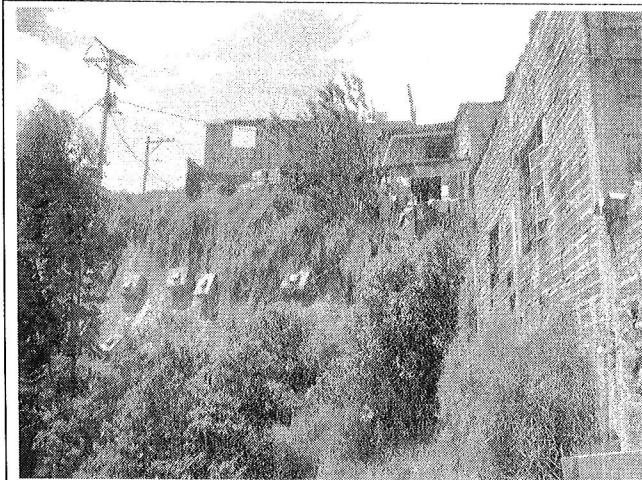
Fotografía 7. Vista de las obras implementadas para mitigación del proceso de caída de rocas. Dicha obra solo cubre parte del talud.
