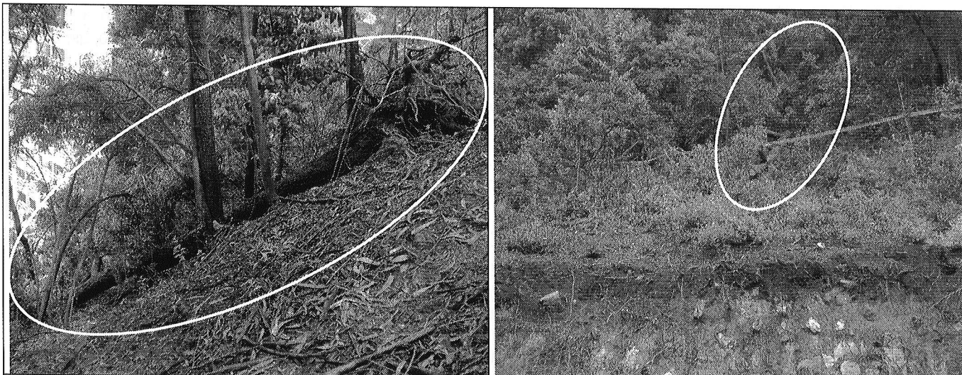
Foto 13 y 14. En la parte alta del talud de corte se observa el tronco de un árbol que según la inspección visual no está anclado al terreno y podría deslizarse de no adelantarse su retiro controlado.
