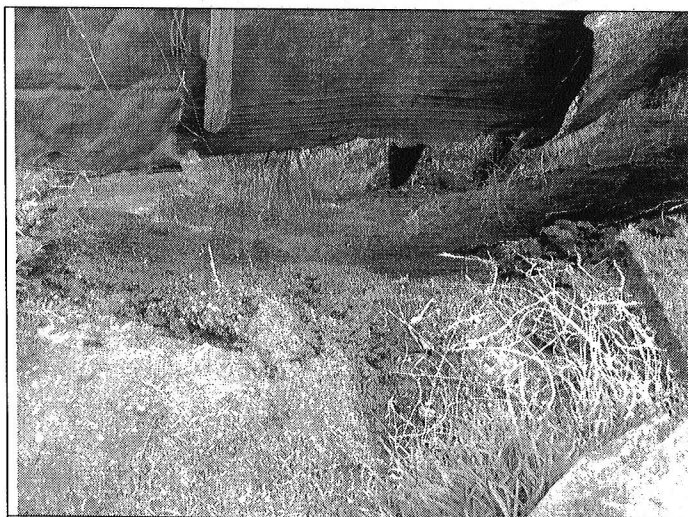
Foto 3. Vista del costado occidental del predio de la Carrera 5 Este No. 40A-07, donde se identifico la perdida del suelo del patio de ropas.
