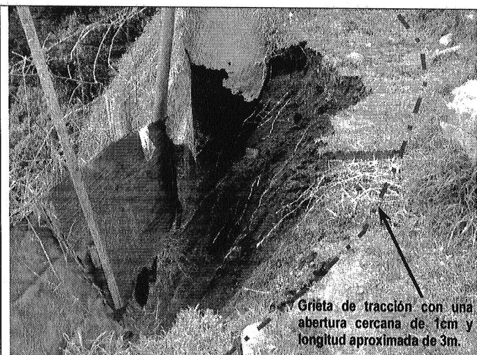
Foto 4. Vista del costado occidental del predio de la Carrera 5 Este No. 40A-07, donde se evidencia la perdida del suelo del patio de ropas para el predio en comento, adicionalmente se evidencia una grieta de tracción con una abertura cercana de 1cm y una longitud aproximada de 3m.
