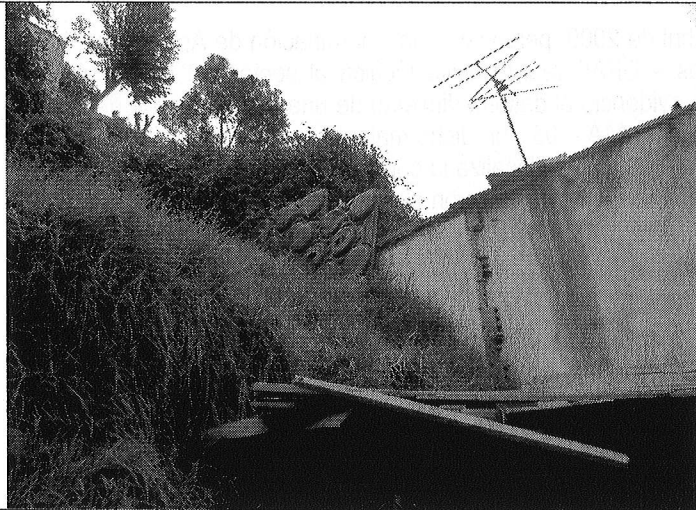
Fotografía 1. Vista lateral de la vivienda emplazada en el predio de la Carrera 2B No. 41A-03. Se evidencia el desprendimiento de materiales del talud y cobertura vegetal sobre la cubierta de la vivienda. Abril 02 de 2009.
