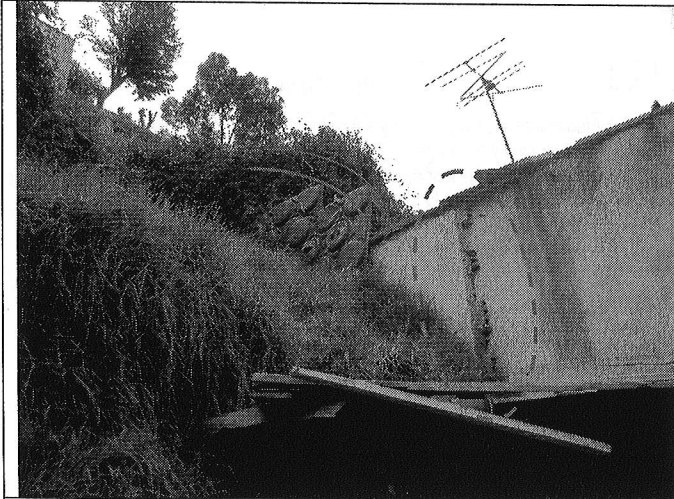
Fotografía 5. Se observa el costado sur de la vivienda donde se evidencia la masa deslizada que se deposita sobre la estructura de cubierta de la vivienda. Nótese que los muros de cerramiento están contruidos en mampostería y no resultan competentes para resistir presiones de tierra.
