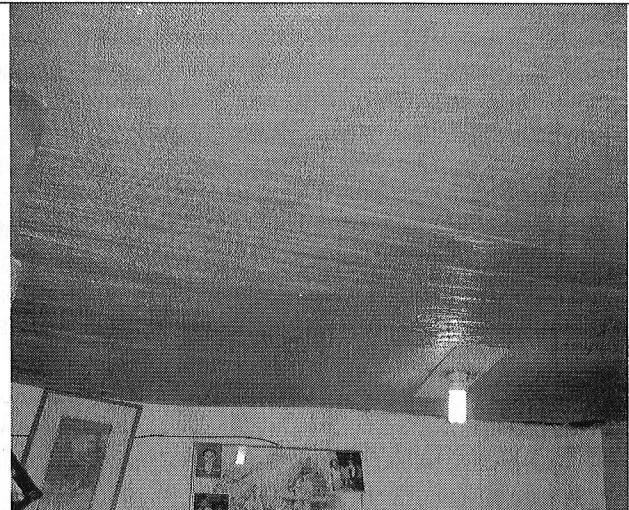
Fotografía 2. Vista desde el interior del predio de la Carrera 2B No. 41A-03, se observa el material desprendido que se depositó sobre una polisombra que recubre el machimbre en madera colocado como acabado de la cubierta la cual se partió por cauda del impacto. Abril 02 de 2009.
