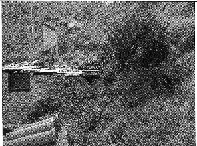
Foto 4. Parte posterior de los predios evaluados. Se observa la parte baja del posible frente de explotación de materiales. Los taludes de corte posiblemente realizados para el emplazamiento de las viviendas evaluadas, se realizan en el material arcilloso depositado en la parte baja del posible frente de explotación de materiales en cemento.
