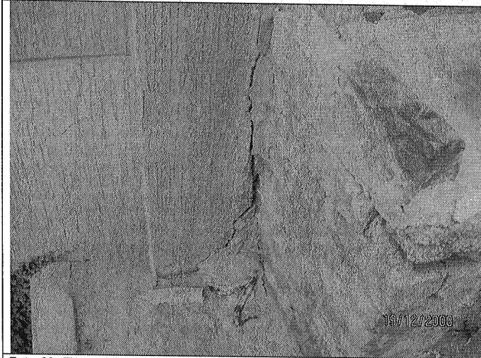
Foto 39. Fisura en muro y desprendimiento de pañete, presentada en el costado sur este, del lote 15 de la manzana 5, con un ancho de 2mm aproximadamente (De acuerdo a la Figura 1).
