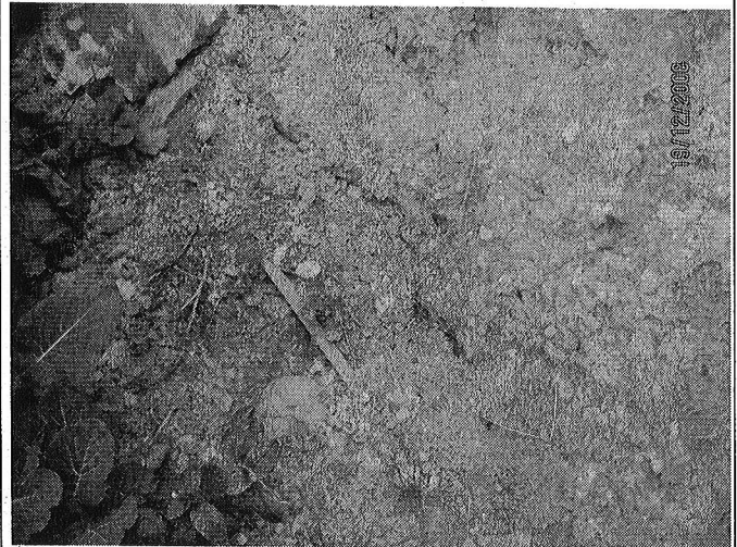
Foto 18. Fisura en suelo, la cual evidencia el proceso de inestabilidad, la cual esta afectando el lote 2 de la manzana 19 del sector (De acuerdo a la Figura 1).
