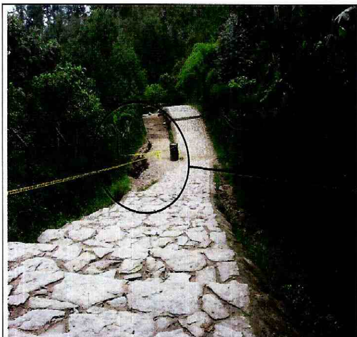
Foto 1. Vista Sur-Norte del sendero peatonal que conecta la Avenida Circunvalar con el Santuario de Monserrate, Fotografía tomada en el sector identificado como "casa del peregrino". Se observa el sector del camino afectado por el proceso de remoción en masa identificado.
