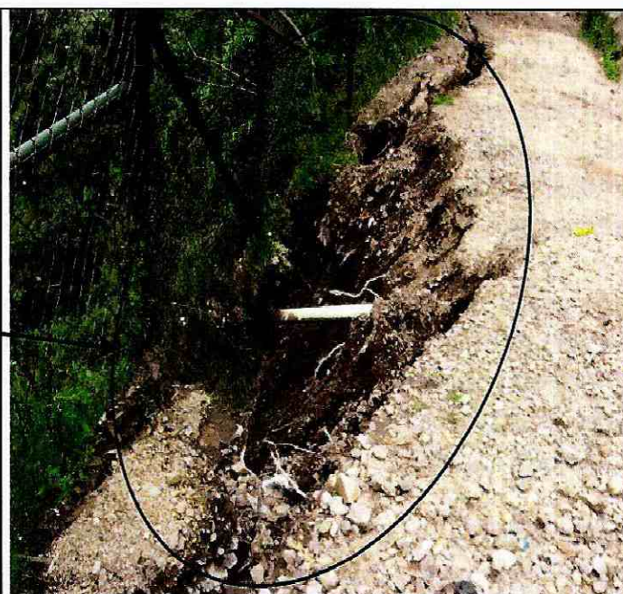
Foto 2. Escarpe principal del proceso de remoción en masa identificado. Se observa el desconfinamiento del sendero peatonal, en una longitud del mismo cercana a los diez (10) metros. Adicionalmente se observa una tubería en PVC de aproximadamente cuatro (4) pulgadas, que estaría vertiendo sus aguas sobre el cuerpo del talud.
