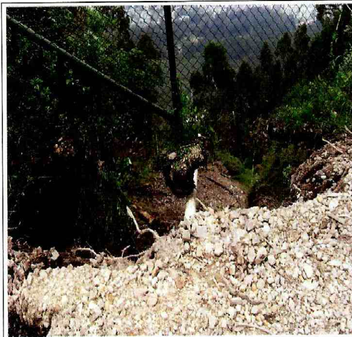
Foto 5. El escarpe principal del proceso de remoción en masa, se localiza en el sendero peatonal aproximadamente a 1.7 metros de la malla de cerramiento del mismo, por su costado occidental.
