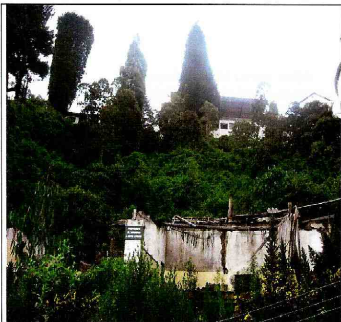
Foto 3. Costado oriental del sendero peatonal en el sector del mismo afectado por el proceso de remoción en masa. Las características topográficas del sector favorecen el aporte de las aguas de escorrentía superficial sobre el cuerpo del talud.
