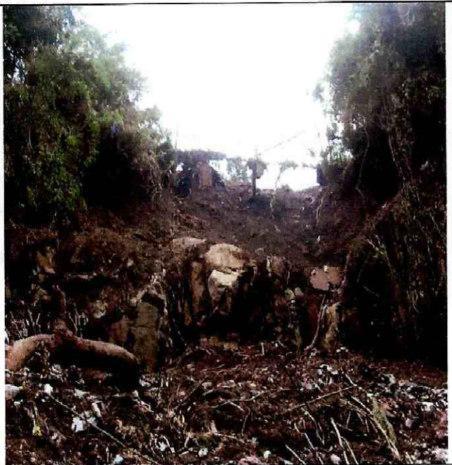
Foto 6. Vista general del cuerpo del talud natural y de relleno afectado por el proceso de remoción en masa. La pendiente del talud es cercana a los 90 grados. Adicionalmente en el sector visible del talud se observa que el 50 % del mismo esta compuesto por roca y el 50 % restante por suelo limoso cubriendo la roca.
