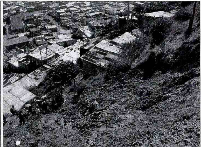
Foto 6. Vista Local de la parte baja de la ladera natural en el sector de la misma directamente afectado por el proceso de remoción en masa identificado. Se observa la intervención antrópica del sector, a cargo de la comunidad, posiblemente con el objetivo de recuperar algunos enseres sepultados por el material desprendido.
