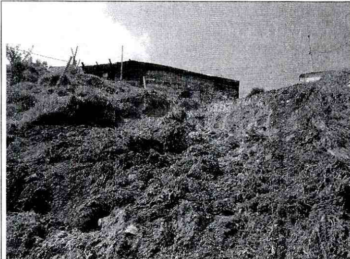
Foto 5. Vista local de la parte alta de la ladera directamente afectada por el proceso de remoción en masa identificado. El material desprendido esta compuesto principalmente por limo orgánico y arcilla.
