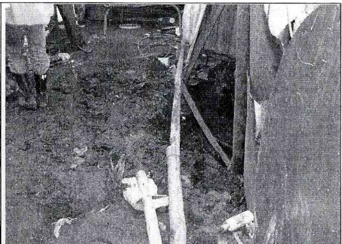
Foto 1. Vista superior talud de corte y relleno evaluado. Se observa el desconfinamiento del terreno de cimentación de la vivienda de la Carrera 75 # 76 - 68 Sur, Lote 9 de la Manzana 23.
