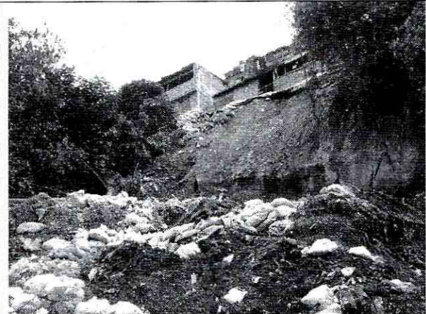
Foto 4. Vista del escarpe del deslizamiento y de la zona de acumulación del material inestable.
