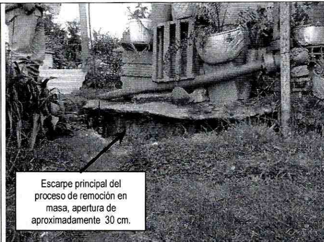
Foto 2. Escarpe principal del proceso de remoción en masa identificado. Se observa una apertura de aproximadamente 30 centímetros.
