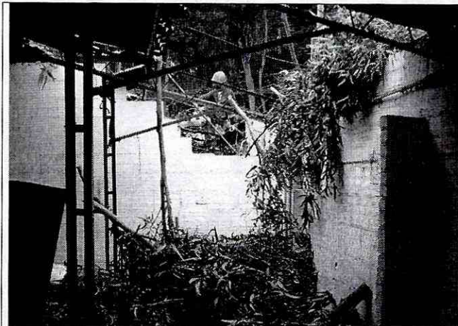
Foto 3. Vista al interior de la vivienda. Se observa los daños en la cubierta, la cual resultó comprometida en aproximadamente 30 m².
