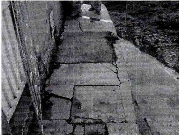
Fotografía No. 1. Foto tomada septiembre de 2008, nótese deterioro en la placa de piso (zona de andén) reflejado en la presencia de grietas y hundimiento leve, parte frontal del predio identificado como Calle 72B sur No. 18J-58 (Calle 70 H # 18 J - 58 sur).
