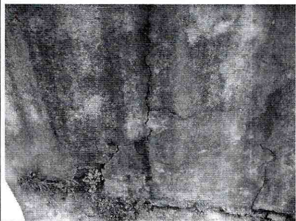
Fotografía No. 2 Foto tomada en septiembre de 2008. Nótese la presencia de grietas en el muro que conforma el antejardín del predio localizado en Calle 72B sur No. 18J-58 (Calle 70 H # 18 J - 58 sur).
