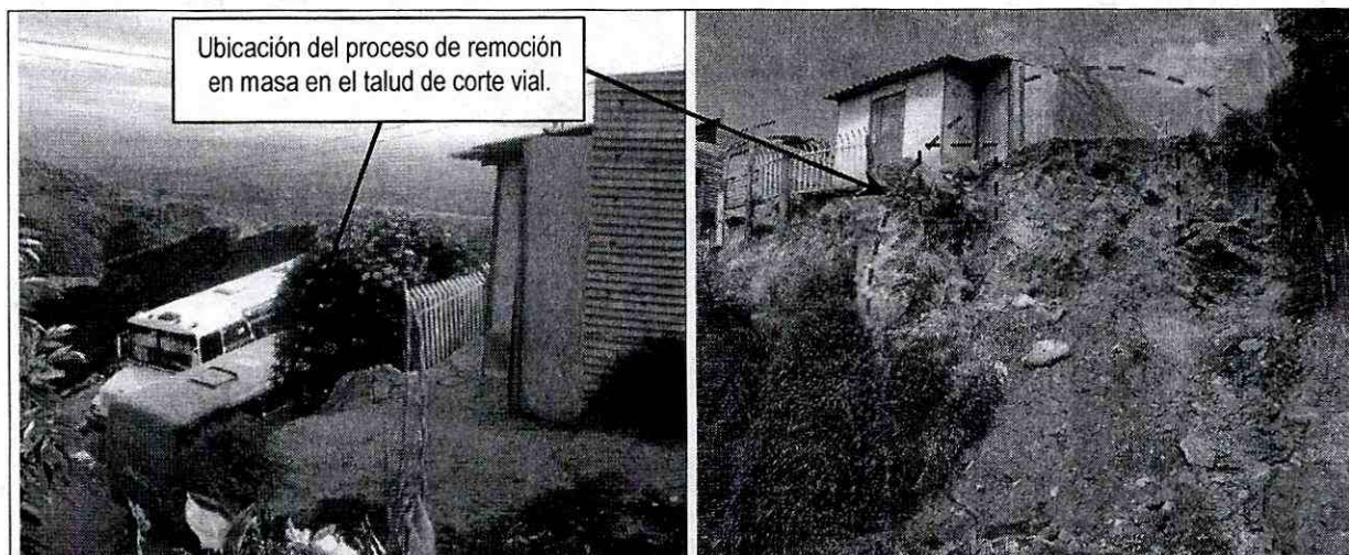
Foto 1 y 2. Distribución espacial de la vivienda ubicada en el predio de la Carrera 23A # 70 – 08 Sur, el talud de corte vial afectado por el proceso de remoción en masa y la Calle 70 Sur.
