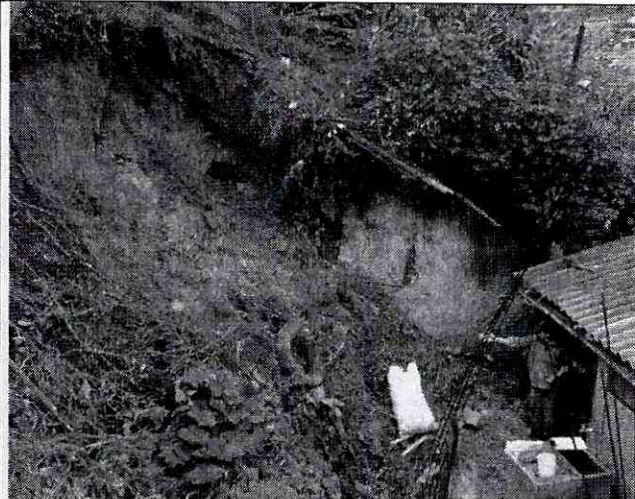
Foto 2. Cuerpo del proceso de remoción en masa y afección del mismo al predio de la Calle 76 Sur # 16 - 04.
