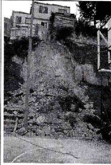
Foto 1. Vista frontal de la zona afectada por el proceso de remoción en masa.
