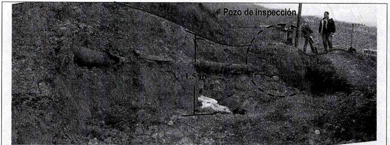
Fotografía No. 3. Aspecto de la vía de la Carrera 6 Este con Calle 1. Se aprecia la falla parcial de la banca de la vía, en la corona del deslizamiento, además de la pérdida de piso de cimentación y/o desconfinamiento del pozo de alcantarillado, fotos tomadas el 29 de Julio de 2008.
