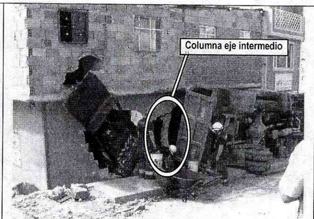
Fotografía 2. Afectación en los muros del costado sur de la vivienda de la Carrera 77C No. 59A-32 Sur generados por el impacto del platón y la cabina de la volqueta volcada, y del vibrocompactador.
