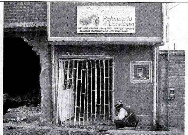
Fotografía 4. Afectación en la fachada de la vivienda de la Calle 59B Sur No. 77B-50. Solo se registraron daños en la carpintería metálica.
