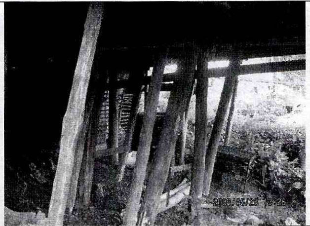
Fotografía 2. Detalle de elementos de soporte de la vivienda. Se observa pérdida de verticalidad en los palafitos que conforman la cimentación de la vivienda.
