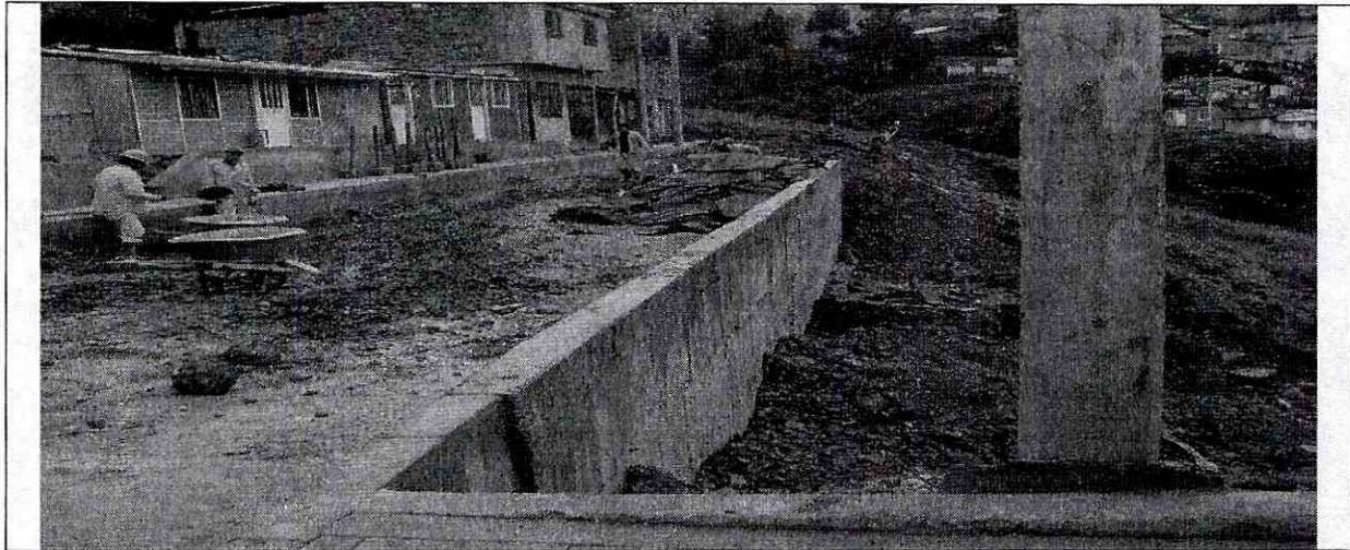
Foto 7. Vista Panorámica del muro en concreto para el talud vial de la Carrera 10 Este.
