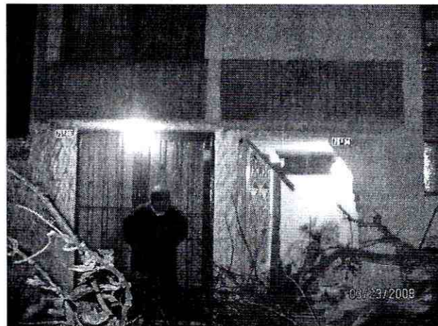
Fotografía 2. Detalle de la fachada de las viviendas de la Calle 89 No. 79B-34 (derecha) y de la Calle 89 No. 79B-40 (izquierda). Apréciense los daños en el sector de la puerta de la vivienda de la Calle 89 No. 79B-34.
