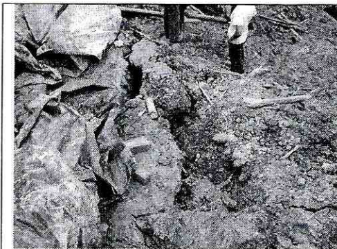
Foto 6. Evidencia de grietas a tracción con aberturas entre 5cm y 10cm, ubicadas en la parte media de la ladera evaluada (Fotografía tomada el 11-04-08).
