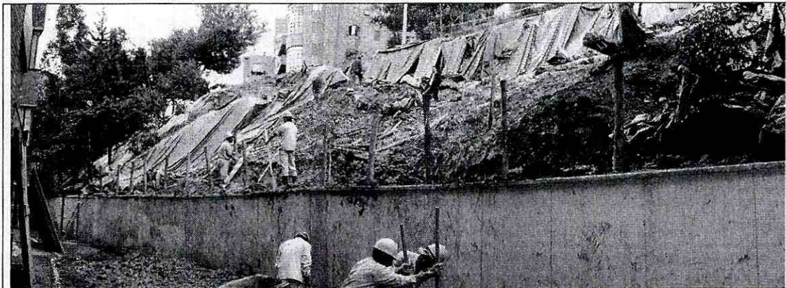
Foto 9. Vista parte inferior de la ladera evaluada, se evidencia el retiro del material movilizado, descrito en el Diagnóstico Técnico No. DI-3642, de igual manera, se observó el inicio de la implementación de un tablestacado, como medida de contención en el sector, por parte del IDRD (Fotografía tomada el 11-04-08).
