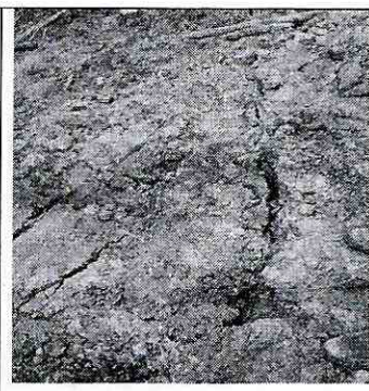
Foto 7. Evidencia de grietas a tracción con aberturas entre 5cm y 10cm, ubicadas en la parte media de la ladera evaluada (Fotografía tomada el 11-04-08).
