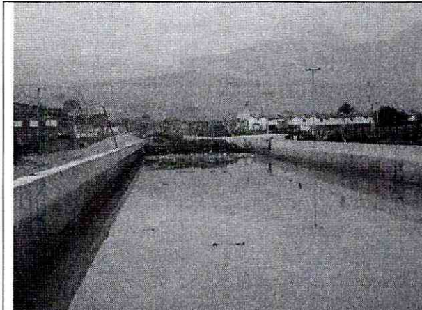
Fotografía 1. Vista general de las obras de canalización de la quebrada Chiguaza, 50 m aguas arriba del punto donde ocurrió la falla del tablestacado y el desbordamiento de la quebrada (tomada en el sentido contrario al flujo de la quebrada).
