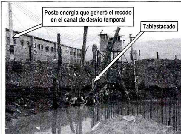
Fotografía 3. Vista del tablestacado construido en la margen derecha del canal de desvío temporal de la quebrada y que falló permitiendo la entrada del agua a la zona de construcción del canal de desviación definitivo.
