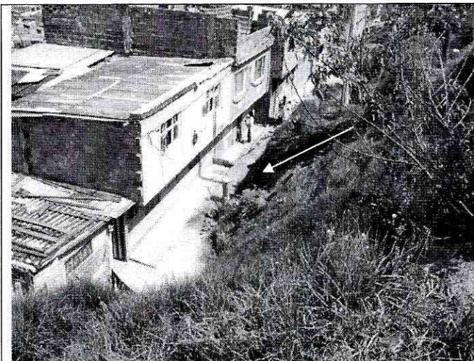
Fotografía 1. Vista general del talud de corte frente al predio de la Calle 69C Sur No. 18-50 y del flujo de tierras
