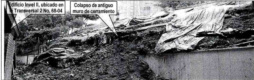
Foto 2. Evidencia de material movilizado, ubicado al interior del área de jardín del Edificio "Invel II", colapso de malla metálica de cerramiento y colapso del antiguo muro de cerramiento de la edificación en concreto.
