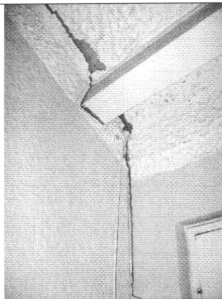
Fotografía 2. Grieta en punto de contacto entre muro divisorio central segundo nivel y cubierta (11-02-2008).
