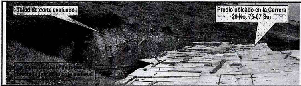
Foto 1. Vista costado sur del predio ubicado en la Carrera 20 No. 75-07 Sur y el talud de corte evaluado.
