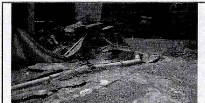
Foto 1. Hundimiento de la banca, costado norte de la Carrera 2 Este en el sector ubicado hacia la parte alta (corona) del talud de corte ubicado al costado sur-oriental del predio de la Calle 71 No. 2-65 Este.
