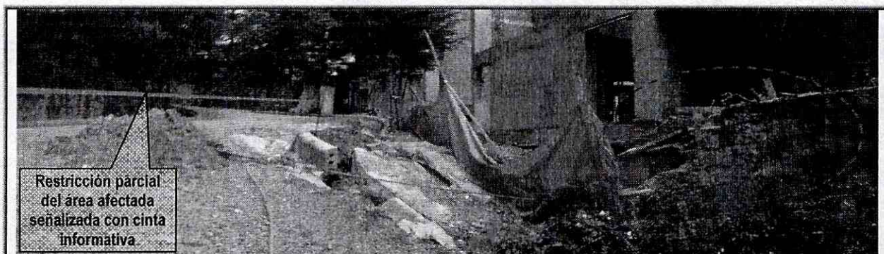
Foto 2. Restricción parcial de uso del sector de la Carrera 2 Este, costado sur-oriental del predio de la Calle 71 No. 2-65 Este y evidencia de colapso parcial del muro de cerramiento perimetral del predio en concreto.
